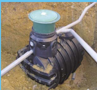
Citerne de récupération d'eau pluviale
